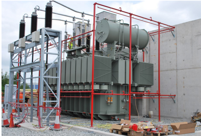
Gambar 2.11 Transformator pada pembangkit
