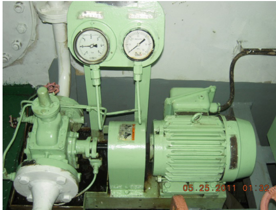
Gambar 2.10 Pompa air pendingin
